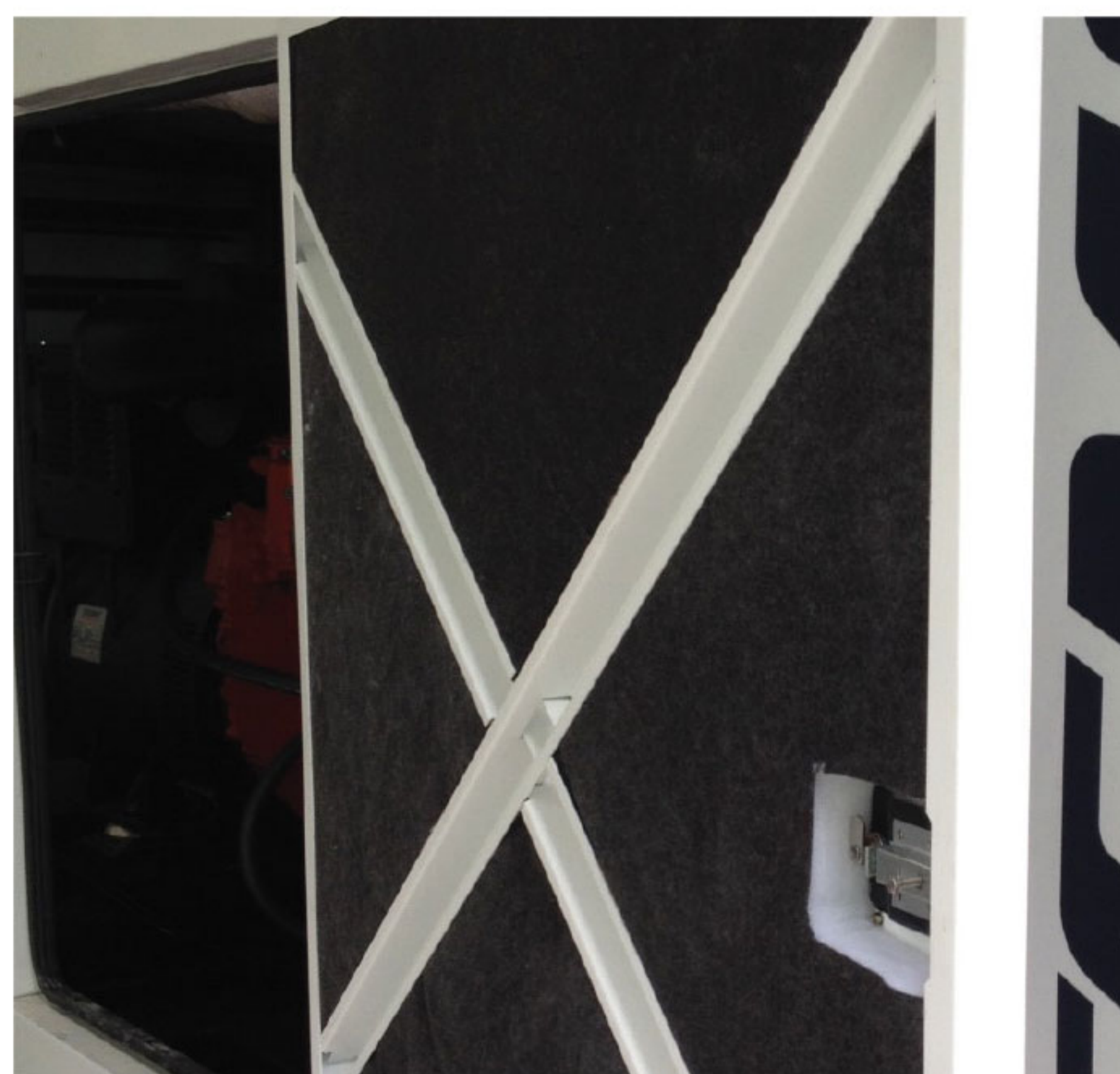
Cabine de unidade geradora
